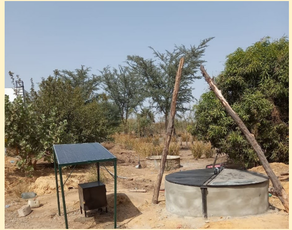
井戸とソーラーポンプ
